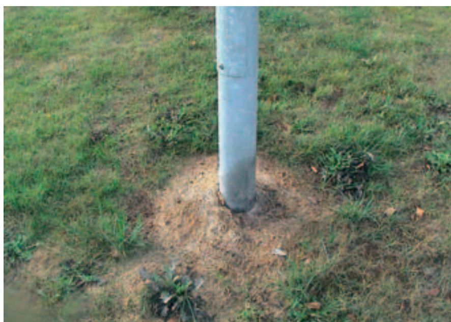
Betonijalusta on asennettu liian syväälle. Humuspitoinen maa syövyttää sinkkiä nopeasti. Ruokamulta on syytä poistaa nopeasti pylvään ympäriltä ja laittaa hengittävämpää hiekkaa tai soraa tilalle.
